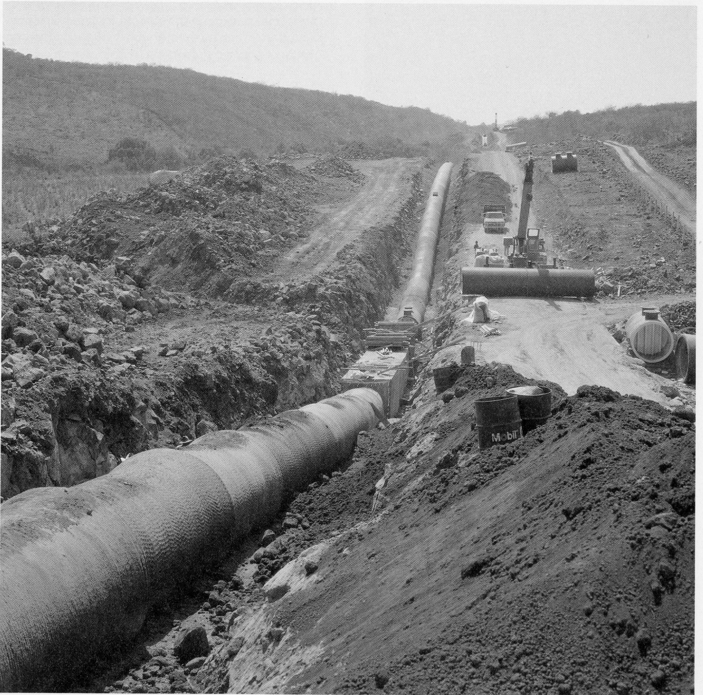
Tramo de tubería terminado. Página opuesta: izquierda, maniobra de tubería de concreto preesforzado; derecha, tramo de tubería acostillado.
