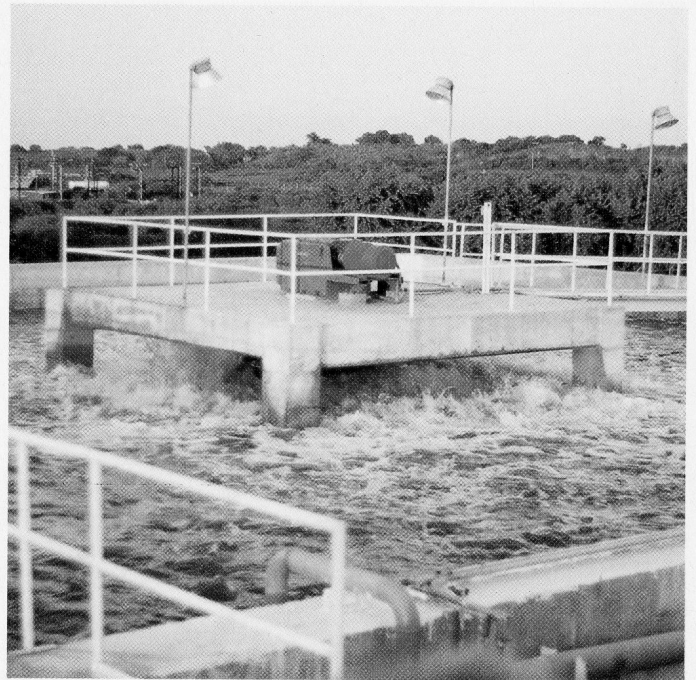
Planta de tratamiento de efluentes. Abajo izquierda, edificio de secado; derecha, edificio de compuestos.
